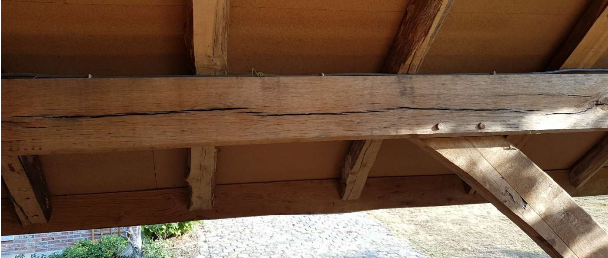
Figuur 29 Eiken vakwerkbalk met overlange barsten na uitdroging, geen probleem toch?
